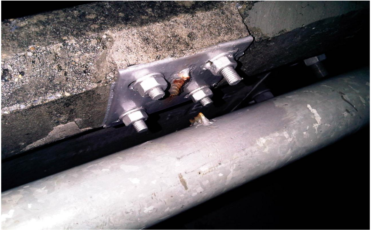
ตัวอย่างรูปภาพ ๑. Handrail ที่ต้องปรับปรุง
