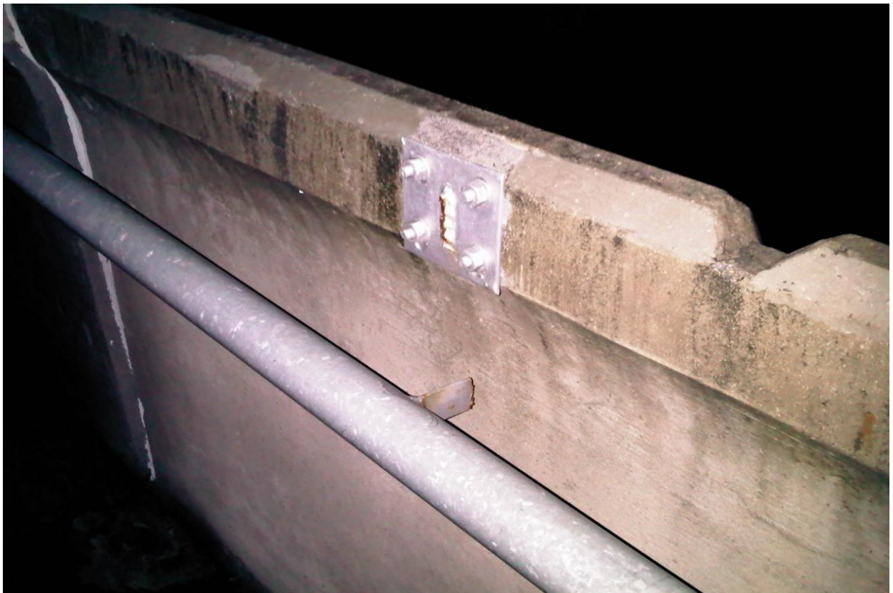
ตัวอย่างรูปภาพ ๒. Handrail ที่ต้องปรับปรุง
